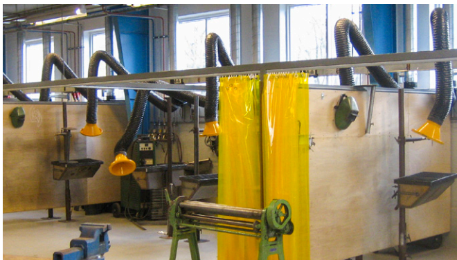
Wing arme \varnothing 160mm 3m installeret på teknisk skole. Inkl. Automatik for automatisk start/stop af ventilator og motorspjæld
